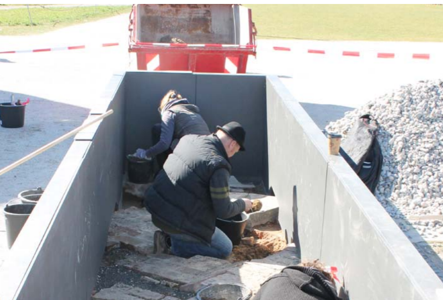
Bestandsdokumentation der Feuchtigkeitsschäden im Archäologischen Fenster der Versöhnungskirche vor der Kapelle der Versöhnung
